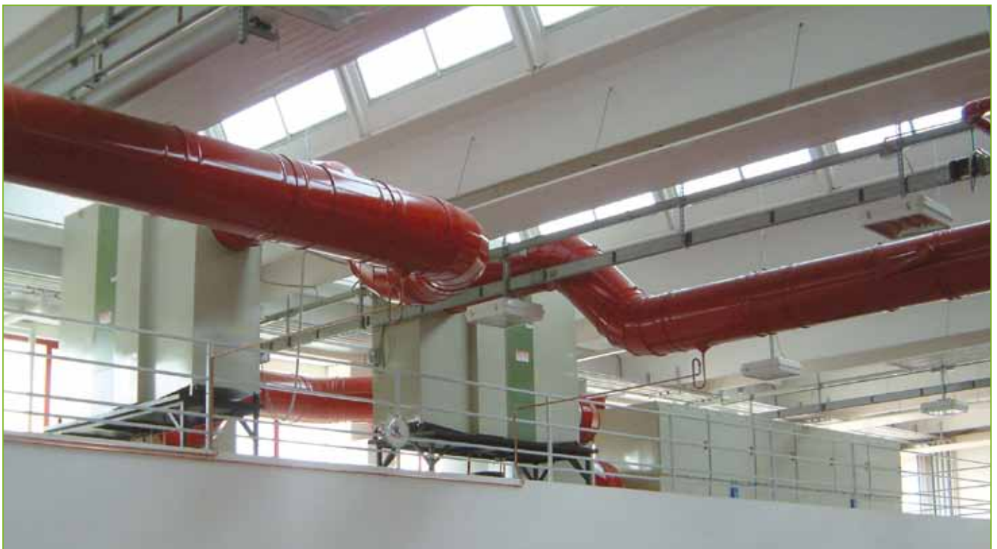
Installazione di batterie filtranti elettrostatiche
